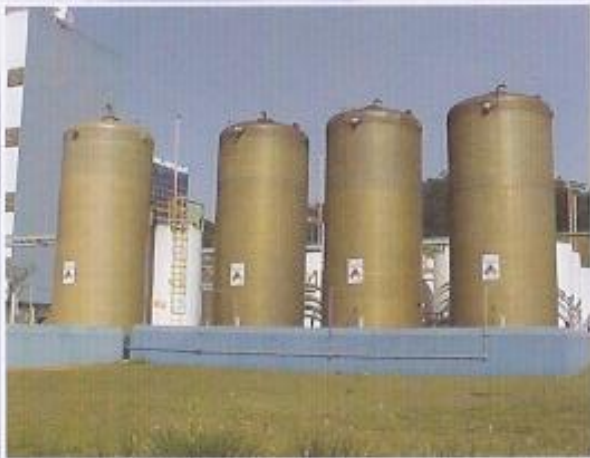
Tanques de Armazenagem de Emulsão Estireno Acrílico
