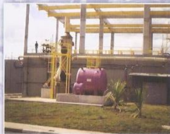
Sistema de Tratamento de Odores
