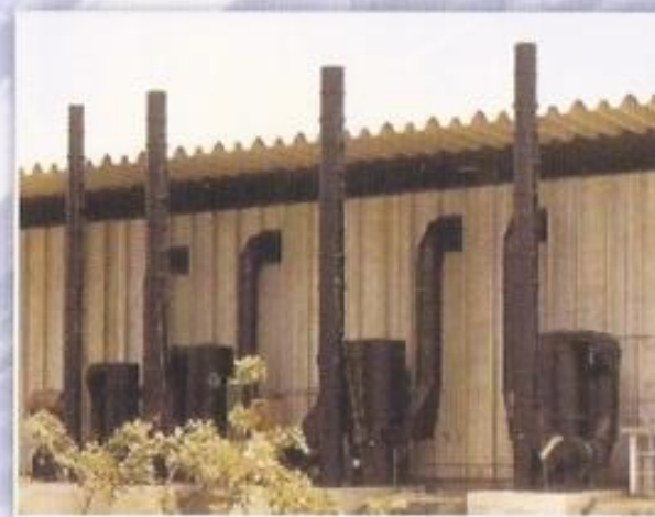
Sistema Depurador para Refino de Ouro
